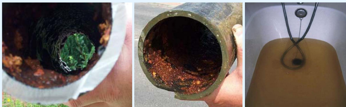
Abb. 1: Ablagerungen in einem Gussrohr und Braunwassererscheinung beim Verbraucher als möglich Folge [Fotos: Vreeburg, 2007].
